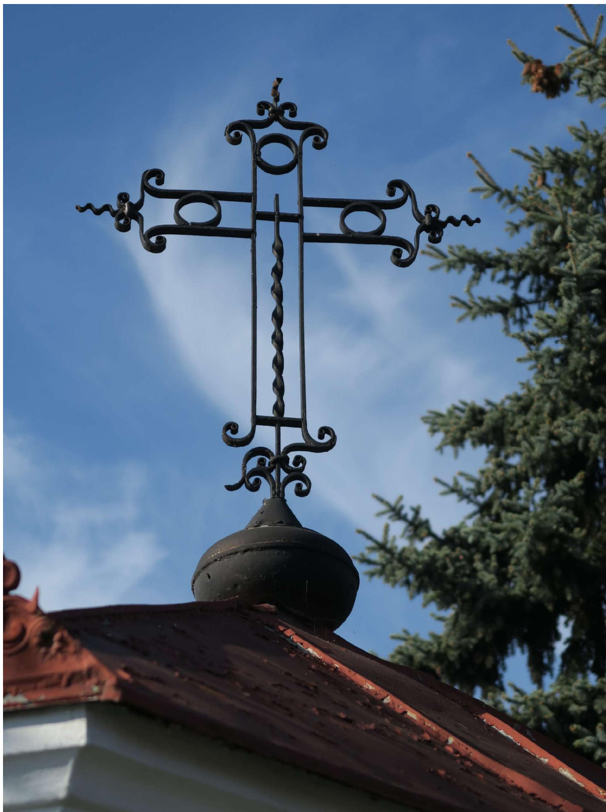
Foto 07 – pohled na kovaný kříž s makovicí (kříž i makovice jsou nahnuté na severozápad) Nedestruktivním zásahem nelze odhalit příčinu této poruchy. Prvek bude šetrně demontován a převezen na dílnu k repasi. Po rozebrání plechové krytiny bude analyzován stav dřevěné konstrukce a případné hrotnice či trnu, na který byl kříž osazen. V rámci opravy bude zajištěno zastabilizování kotevního prvku kříže s makovicí ve vertikální rovině.
