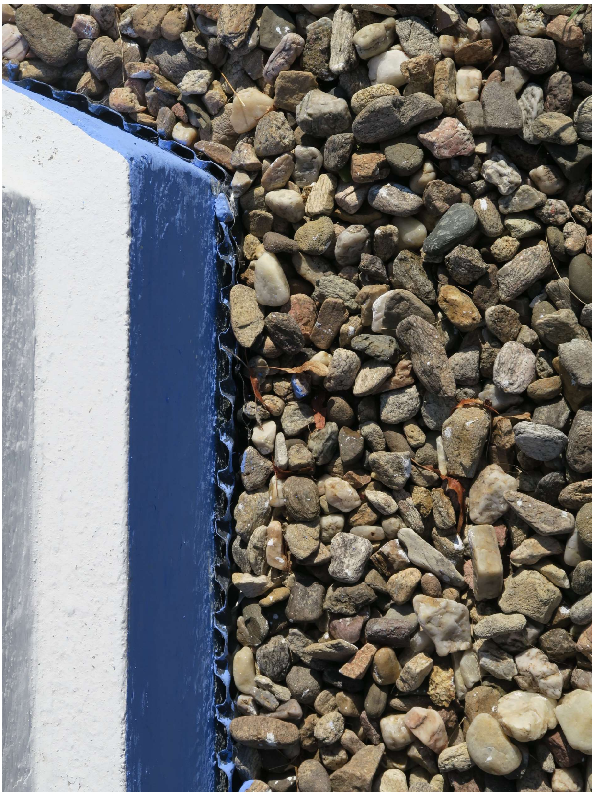
Foto 01 – detail nevhodného ukončení nopové fólie v úrovni okapového chodníku
