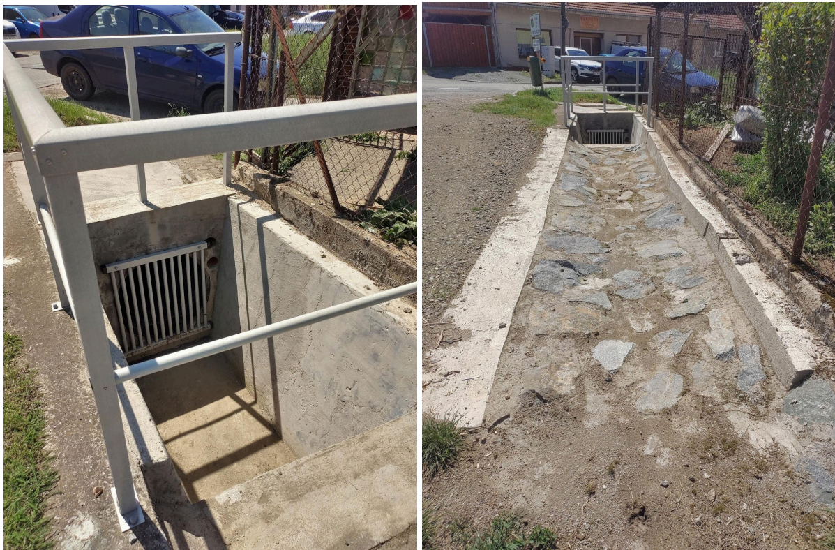
Obrázek 24a a 24b: Horská vpust u domu č. p. 229, která má převádět povrchovou vodu z přilehlých polností do dešťové kanalizace. Trubka vpusti má průměr 0,80 m. (Zdroj: Mapování v rámci studie 2023 – 2024)
